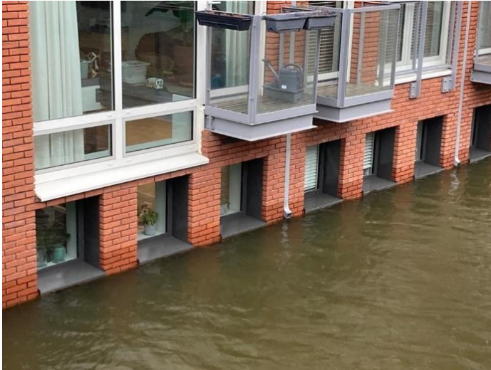
Woningen in de Houthavens waar het water tot enkele centimeters boven het raamkozijn steeg. RWS is beheerder van het water in de Houthavens.
